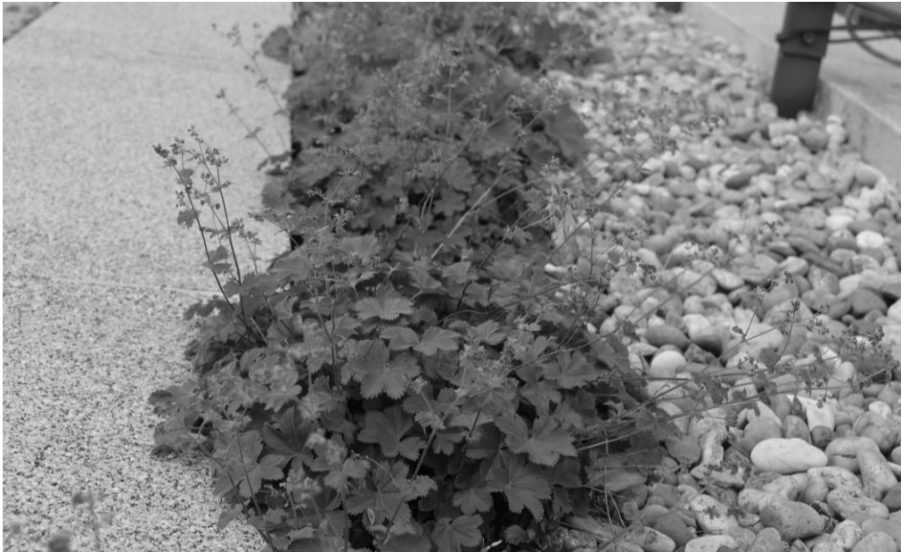
3. ábra. Spontán megtelepedett palástfű (magashegységi évelő faj) az elválasztó kavicsrétegben, extenzív zöldtetőn.
